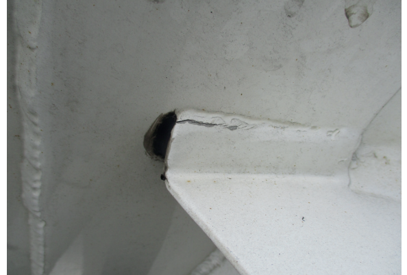
Bild 2: Riss an der Halterung beim Armaturenschrank an einem Tankfahrzeug.
